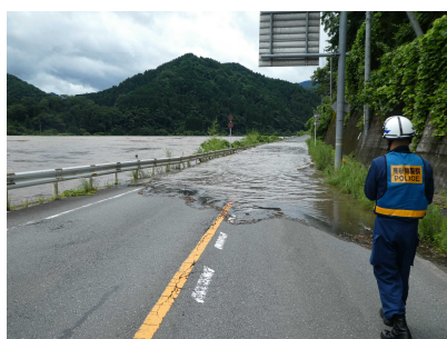
【河川の氾濫による道路の冠水】
