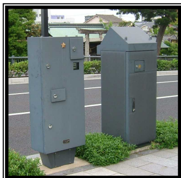
信号制御機と発電機
