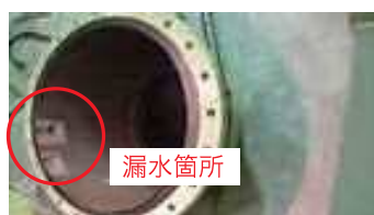
【排水機場排水ポンプ漏水】
