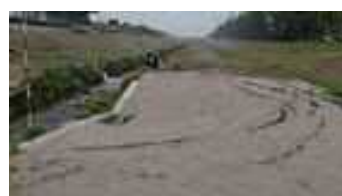
【幹線排水路沈下状況】
