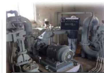
老朽化したポンプ施設
