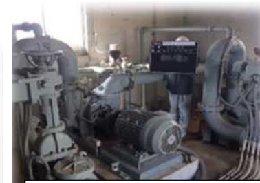
老朽化したポンプ施設
