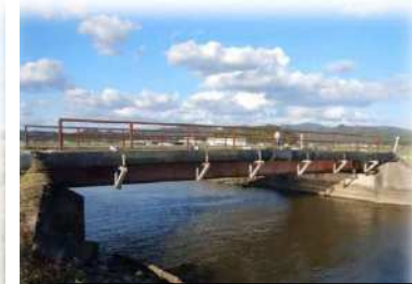
老朽化した水管橋
