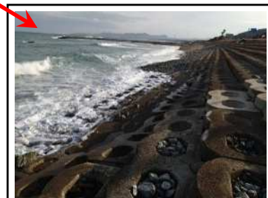
損傷状況 (R5年2月)
