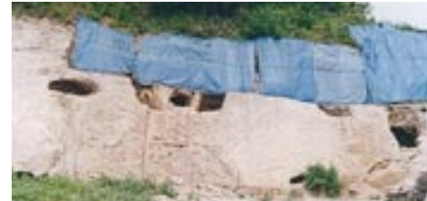
御崎横穴墓群 (知夫村薄毛) くずれた崖面の復旧工事に伴い、4穴を調査。そのうち1穴からあわびの貝がらが出土し、注目された。あわびは、奈良時代に隠岐から中央政府へ献上された品として有名。
