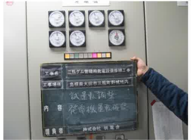
58 発電機運転確認
