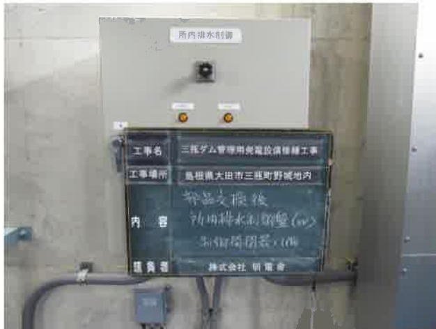
15 所内排水制御盤
