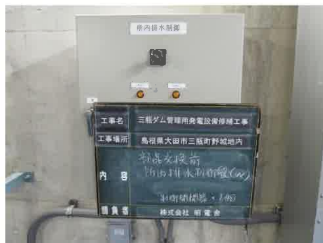
06 所内排水制御盤
