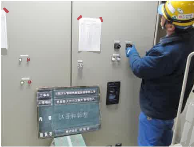
55 配電盤試運転調整(1)
