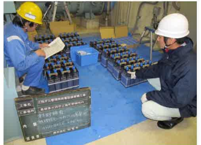
46 材料検査蓄電池
