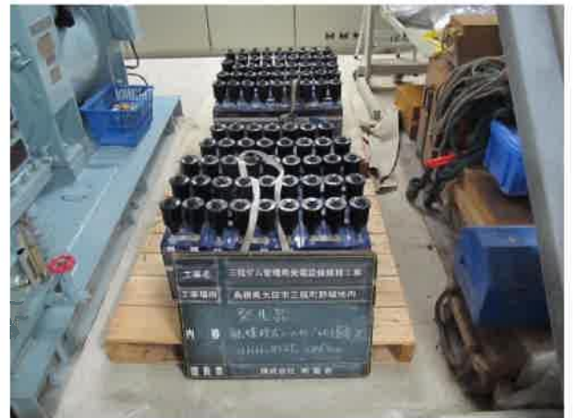
24 蓄電池発生品
