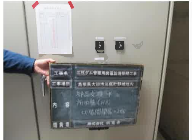
28 所内盤交換中
