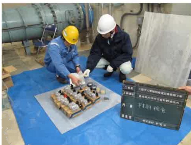
53 材料検査配電盤
