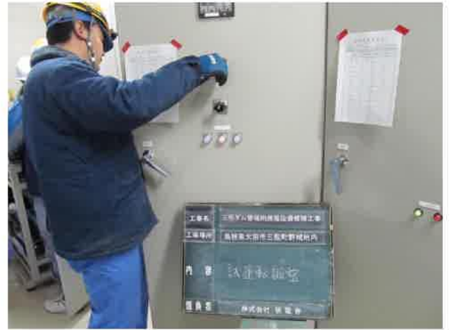
56 配電盤試運転調整(2)
