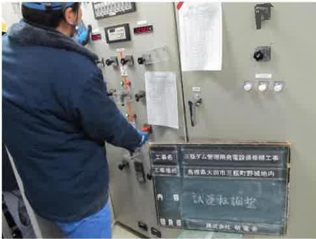
57 配電盤試運転調整(3)
