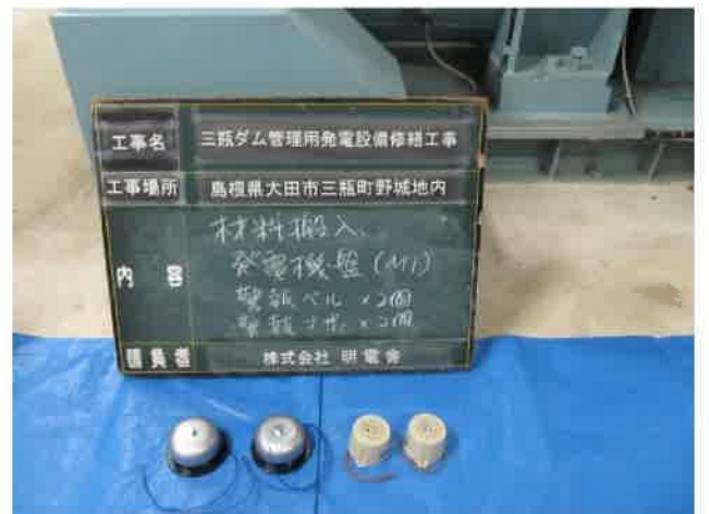
48 材料搬入発電機盤(2)
