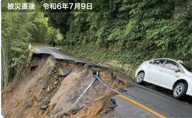
被災直後 令和6年7月9日 大雨により道路が崩壊し、全面通行止め
