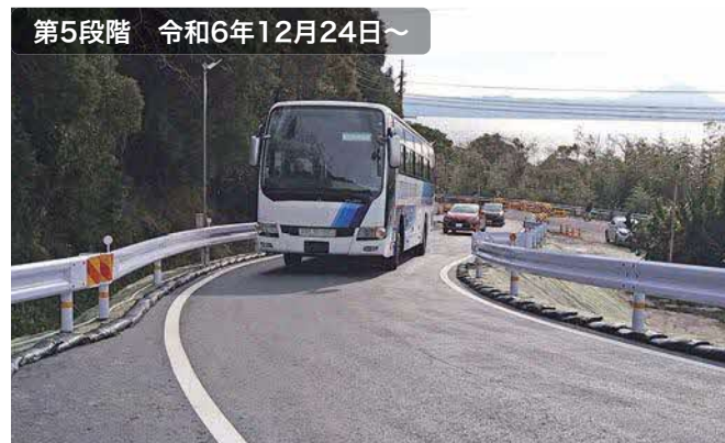
第5段階 令和6年12月24日～ 大型車を含む一般車両の仮設道路を整備(片側交互通行)
