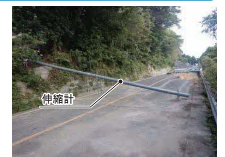
伸縮計の設置状況
