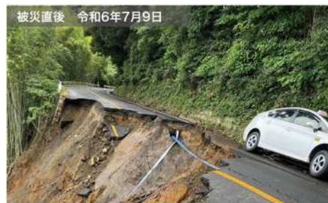
被災状況写真
