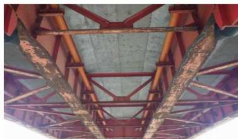
【主桁・横桁の腐食状況】
