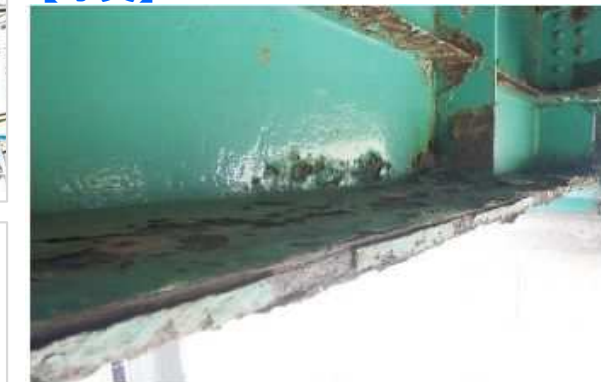
鋼部材の腐食等
