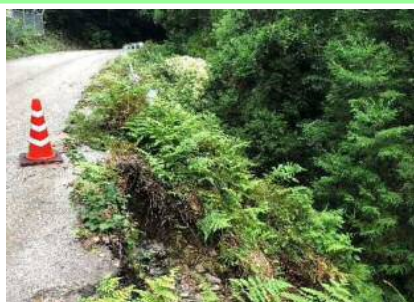
路肩の崩壊状況（海士町）
