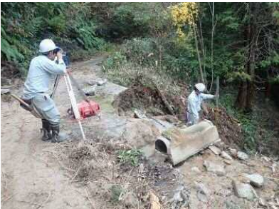
支援協定に基づく被害調査の様子
