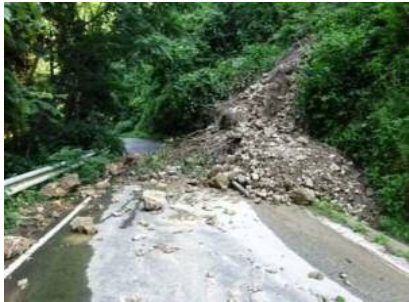
法面の崩壊状況（松江市）
