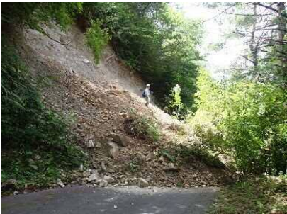
法面の崩壊状況（飯南町）
