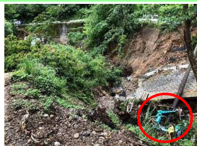
令和2年災の現場にあった重機転倒
