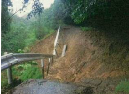
路体の流出状況（出雲市）
