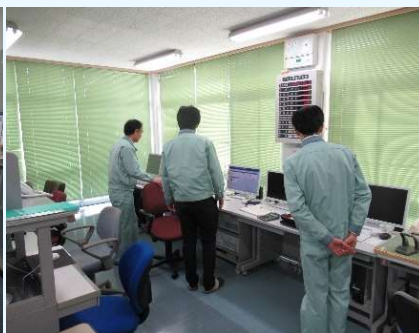
現地確認検査（管理所内操作設備）
