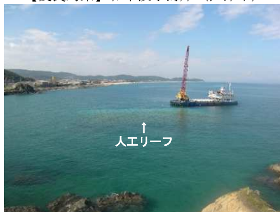
【侵食対策】和木波子海岸（江津市）
