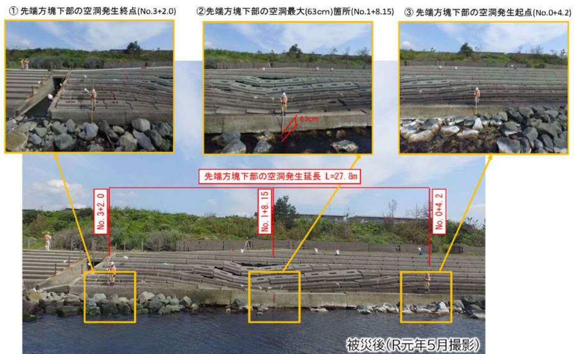
写真-1.3 近年の施設被害の事例
