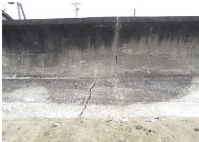
写真-1.4 近年の施設被害の事例
