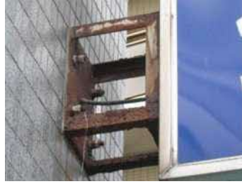
ブラケット・取付部の腐食 (ブラケット)
