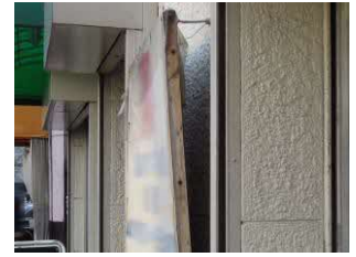
壁面との間に隙間が生じた状態
