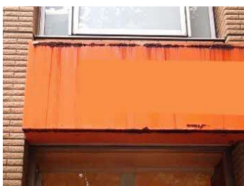
側板の腐食が進行した状態
