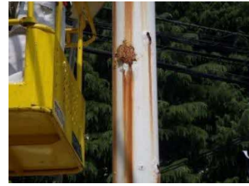
その他（支柱の腐食など）
