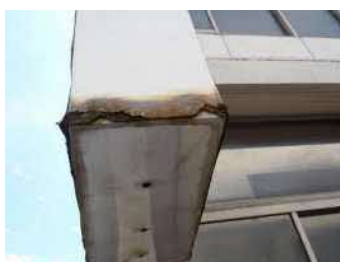
側板の腐食が進行した状態
