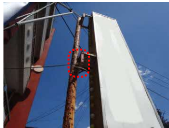
支柱・広告板接合部の腐食・隙間
