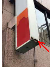
広告板底部の腐食が進行した状態
