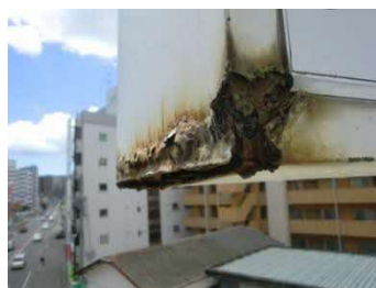
側板の腐食が進行した状態
