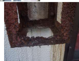
支持部が腐食していた看板の例
