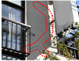
壁面にひびが生じた状態
