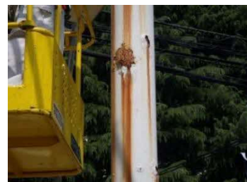
支柱の腐食が進行した状態
