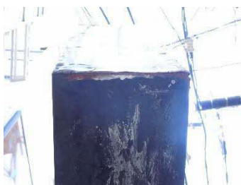
側板底面にさびが発生した状態
