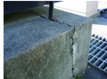
基礎にクラックが入った状態
