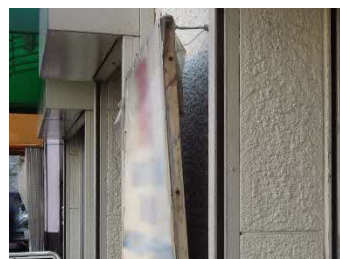
壁面との間に隙間が生じた状態
