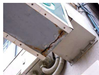
側板底面が破損した状態
