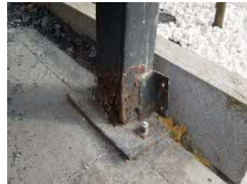
支柱根元の腐食が進行した状態
