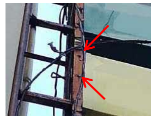
ボルトのゆるみや欠落した状態
