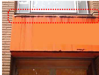
その他（塗装剥離、腐食など）
