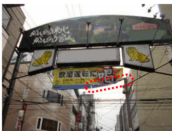
幕材を張る部材が破損した状態
