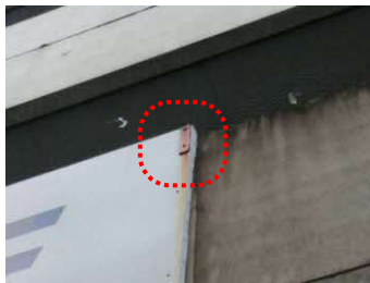
金具が劣化した状態
