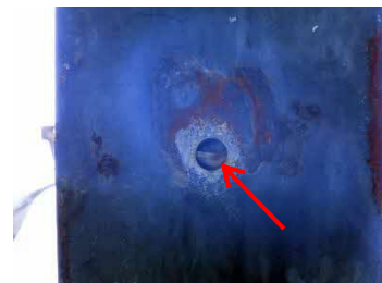
水抜き孔の詰まり
