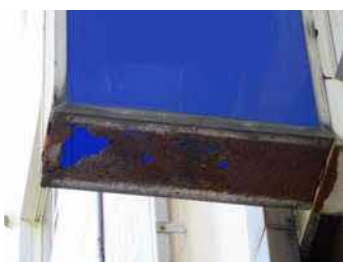
側板底面が腐食、破損した状態
