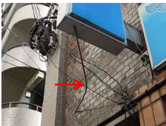
振れ止め棒が変形した状態
