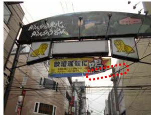
幕材を張る部材が破損した 状態
