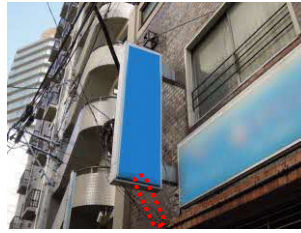
振れ止め棒が変形した状態
