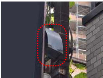
ブラケットカバーが外れかかった状態
