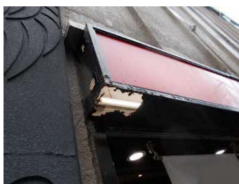
側板底面の腐食が進行した状態
