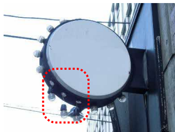
照明器具の傾き、外れ
