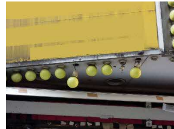
照明器具の傾き、外れ
