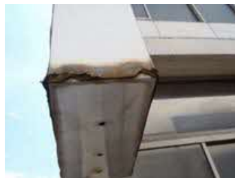
広告板底部の腐食
