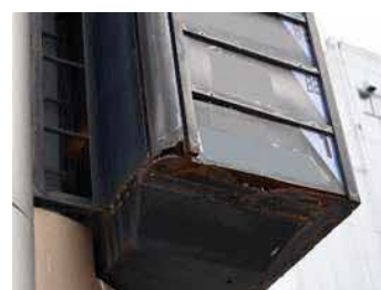
側板底面が腐食、破損した状態
