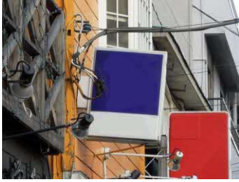
屋外広告物本体の傾き
