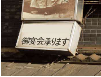
屋外広告物本体の傾き
