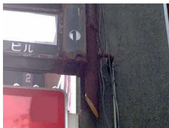
支持部が腐食した状態
