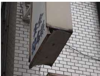
その他 (塗装剥離、腐食など)
