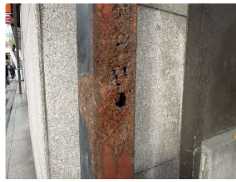
支柱の腐食が進行した状態
