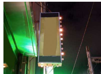
照明の不点灯
