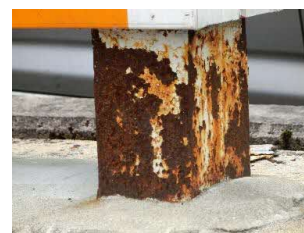
支柱根元の腐食が進行した状態
