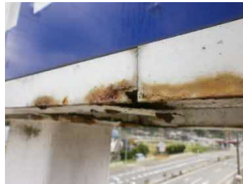
その他（塗装剥離、腐食など）
