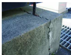
基礎にクラックが入った状態
