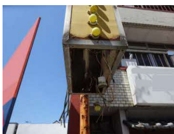
側板底面が欠損した状態
