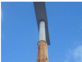
支柱・広告板接合部にさびが発生した状態
