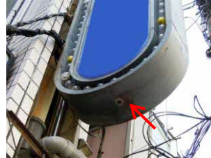
水抜き孔が詰まった状態
