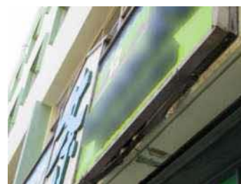
側板底面が破損した状態
