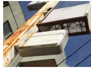
支柱にさびが発生した状態
