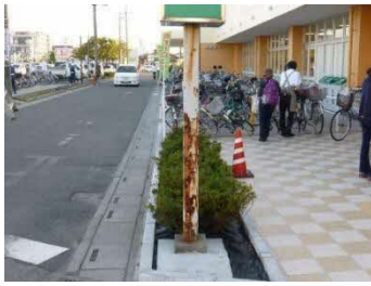
支柱の腐食が進行した状態
