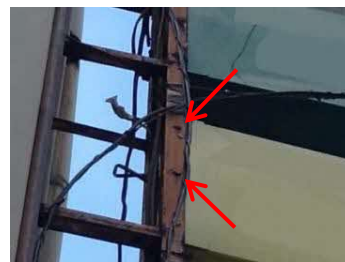
ボルトのゆるみや欠落した状態
