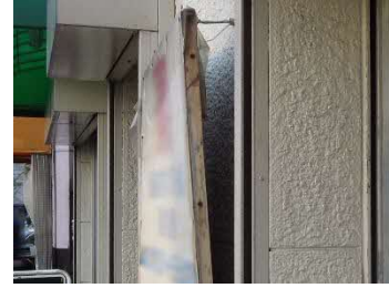
屋外広告物・壁面の隙間、壁面のひび、はらみ、浮き
