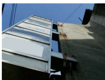
壁面に取付部の汚ダレが見られる状態
