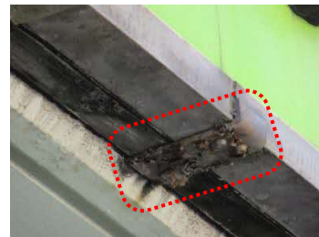
金具が劣化した状態
