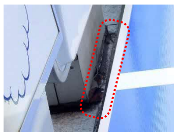
コーキングが劣化した状態
