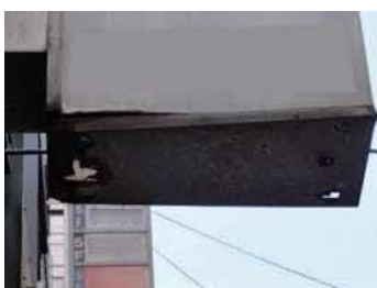
側板底面が腐食、破損、変形した状態
