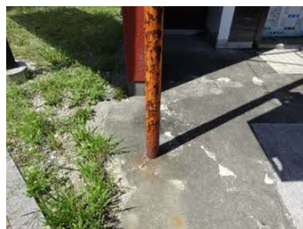
支柱の腐食が進行した状態
