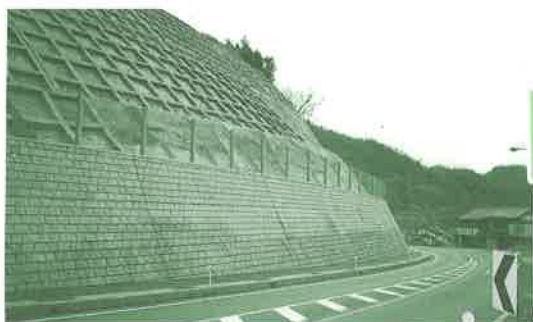
（多伎町） 林地への自然復元の困難なコンクリート法面
