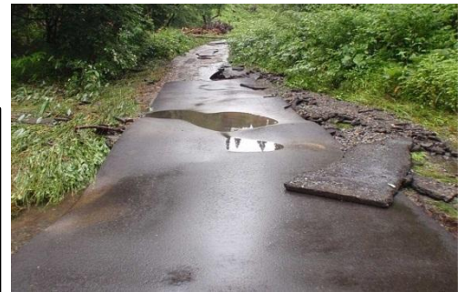
写真：舗装の被災
