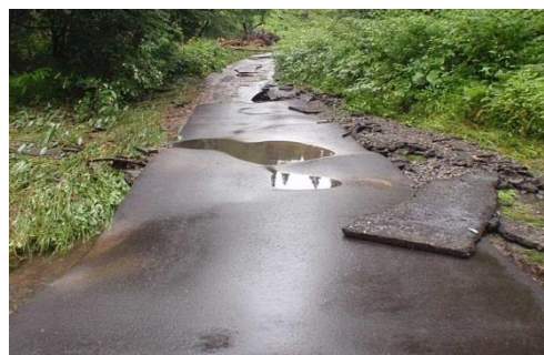
写真：舗装の被災
