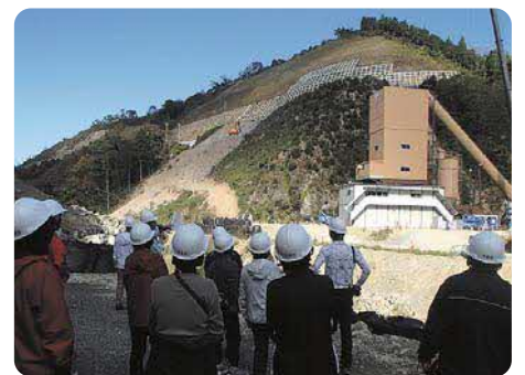
今だけしか観ることができない、刻々と変わる ダム建設現場(波積ダム)
