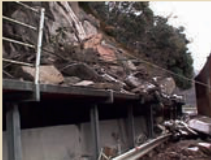
道路周辺の崩壊（日野町）
