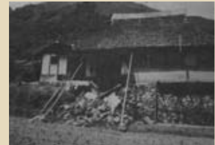
石垣のくずれ（大田市）
