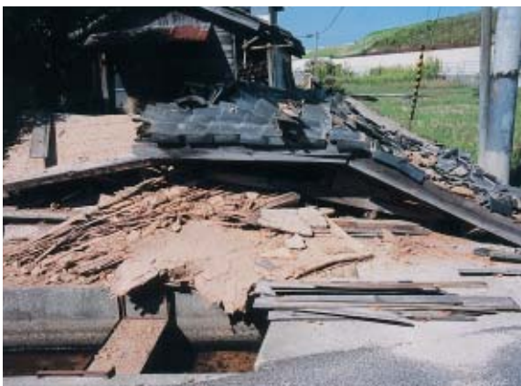
鳥取県西部地震による被害 ひがい
