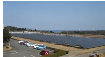
江津浄水場太陽光発電所
