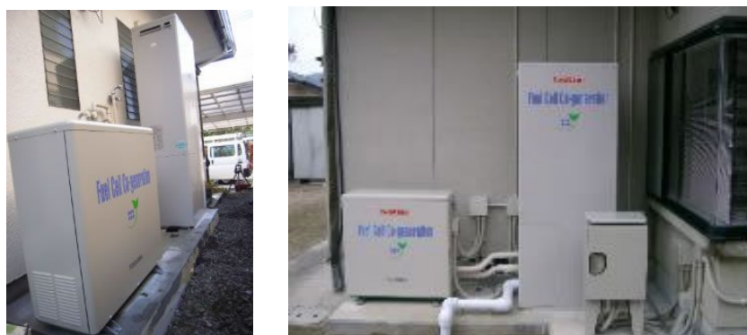
図表 2-10-1. 家庭用燃料電池設置事例
