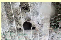
Der Drahtzaun am Hühnerstall ist beschädigt
