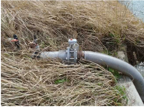
サイフォン配管（バタフライ弁、注入口）
