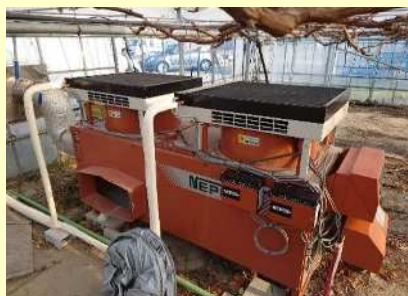
ヒートポンプ
