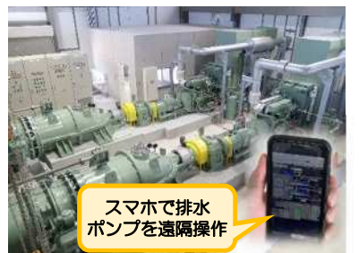
〈用排水機場のICT化〉
