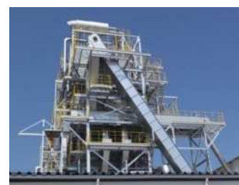
< 木質バイオマス発電所 >
