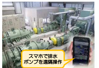
〈用排水機場のICT化〉
