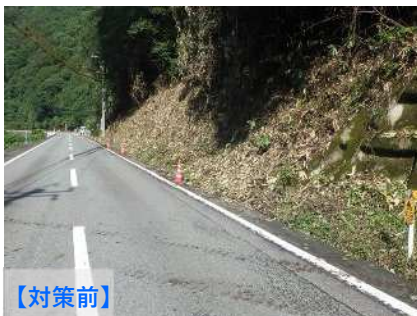
鋼管杭式落石防護柵 （浜田八重可部線 旭町都川）
