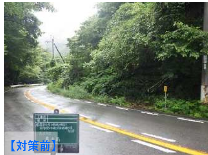
落石防護柵 （R186 金城町長田）
