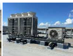
エアコン室外機
