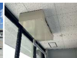
エアコン室内機
