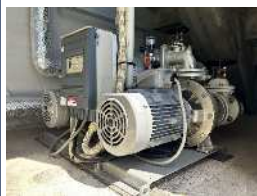
給水用ポンプ
