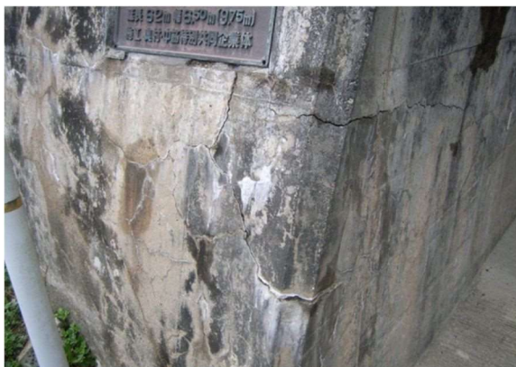
抗門面壁のひび割れ
