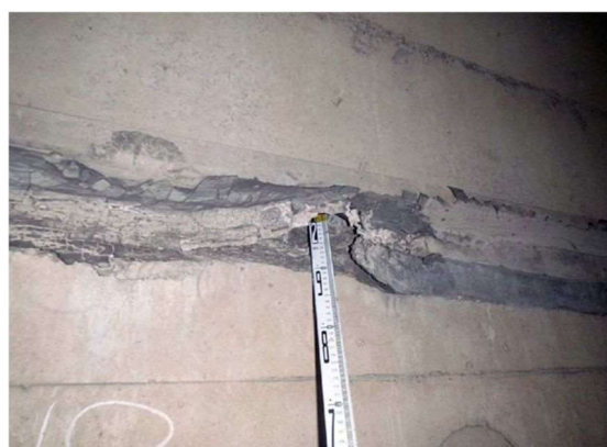
壁面打継部の剥離
