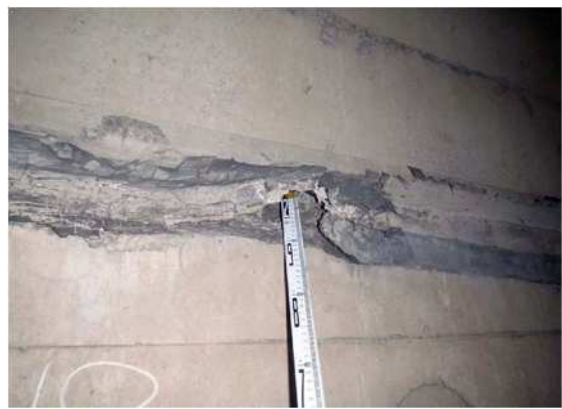
壁面打継部の剥離
