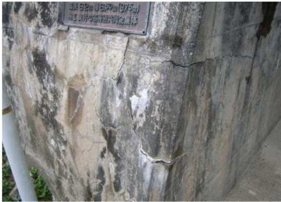
抗門面壁のひび割れ
