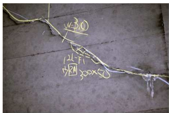
覆工アーチ部のひび割れ
