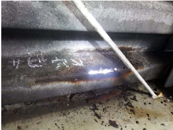
頂版の断面欠損
