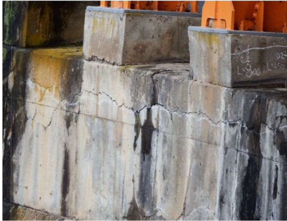
受台のひび割れ
