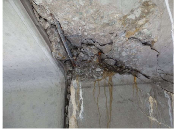
はく落を伴う鉄筋露出（頂版）
