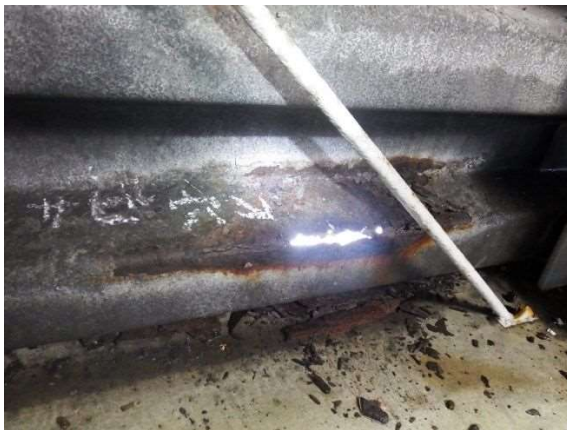
頂版の断面欠損
