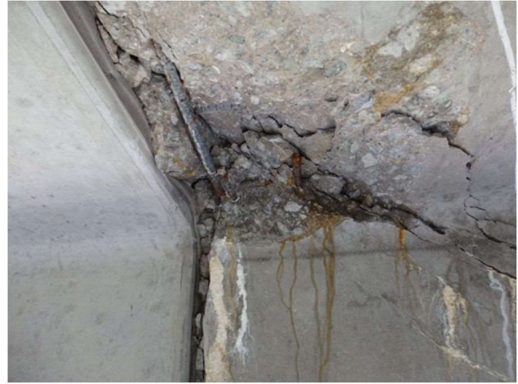
はく落を伴う鉄筋露出（頂版）
