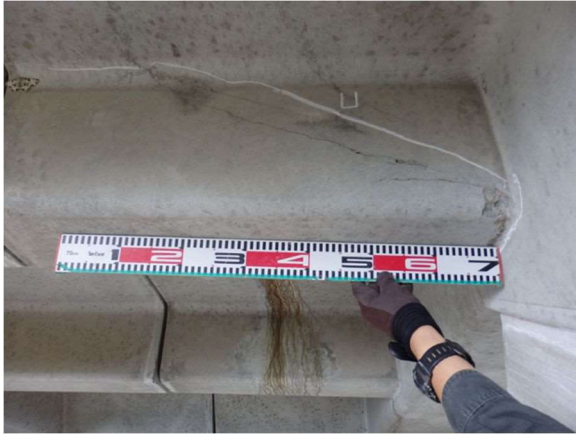
ひび割れ、はく離・はく落（横梁）
