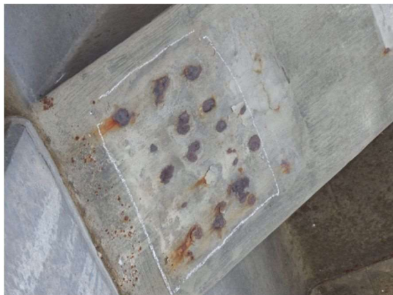
PC 鋼材からの錆汁（主梁）
