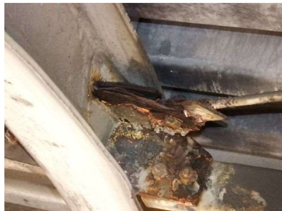
ガセットプレート部分の腐食
