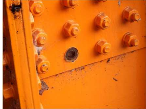
取付ボルト (F11T) の破断
