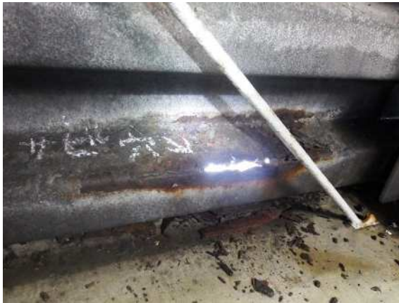
頂版の断面欠損
