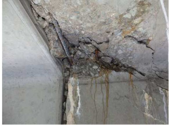
はく落を伴う鉄筋露出（頂版）
