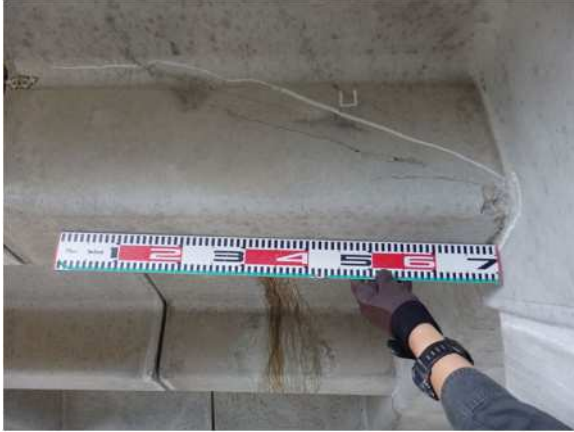
ひび割れ、はく離・はく落（横梁）
