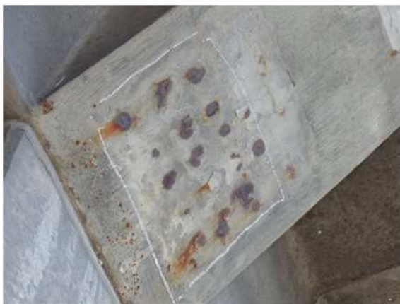
PC 鋼材からの錆汁（主梁）
