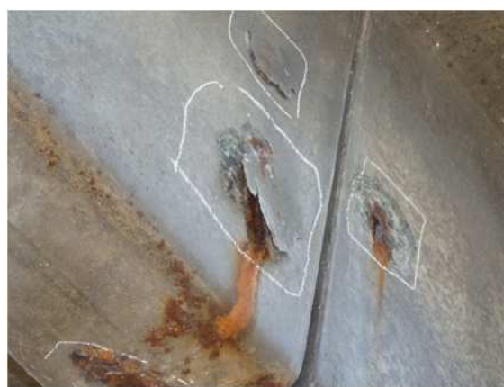
コンクリート剥離、錆汁、鉄筋露出（横梁）
