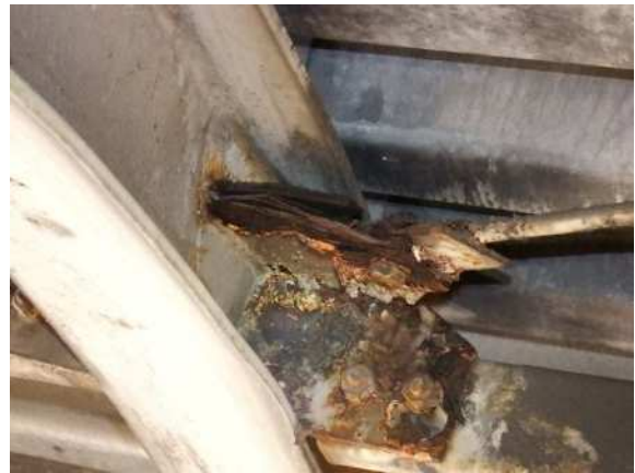
ガセットプレート部分の腐食
