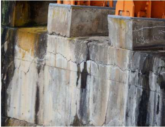
受台のひび割れ
