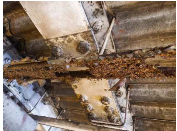
照明取付レールの断面欠損、破断
