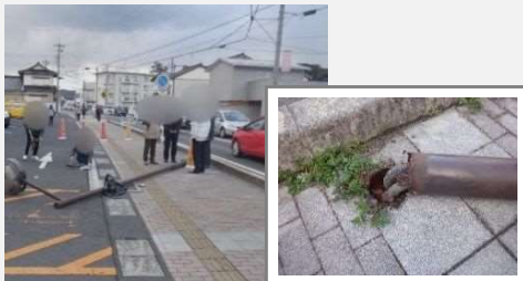
・令和7年1月発生(出雲市大津町) ・道路照明柱が強風で倒壊し、 集団登校中の児童1名が負傷
