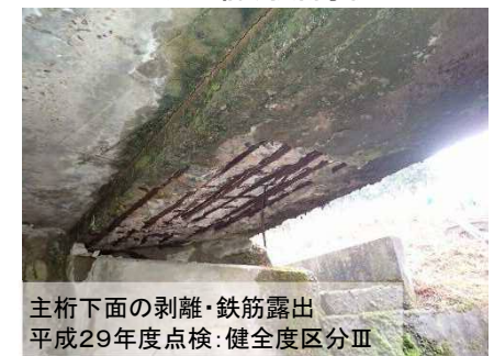
道路橋の損傷事例
