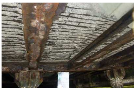
写真－１３ 上部工の劣化（下面側）
