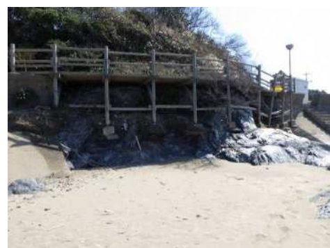
写真－9 侵食による基礎部の露呈
