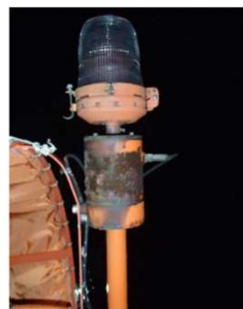
写真一 3 航空灯火劣化状況
