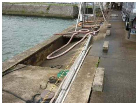
写真－１２ 上部工の陥没
