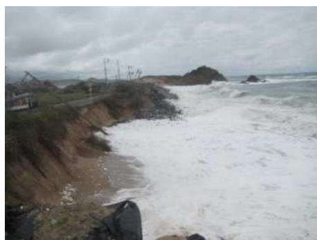
(侵食による被害状況)
