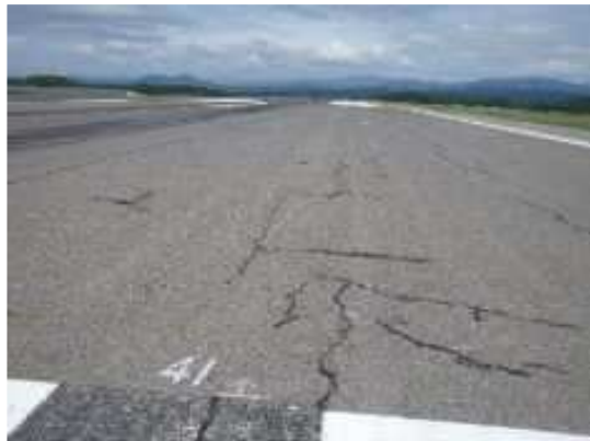
写真－5 滑走路ひび割れ発生状況
