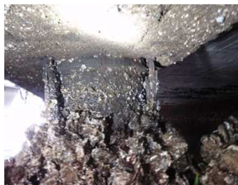
写真－１４ 杭頭部の腐食
