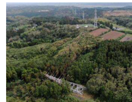
鉄塔設備の倒壊 (君津市)
