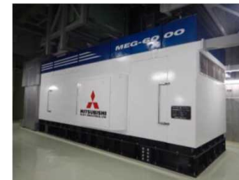
ガスタービン発電機
