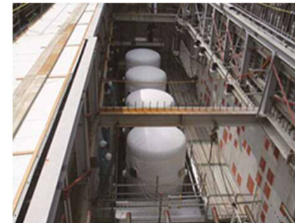
フィルタ付バント設備
