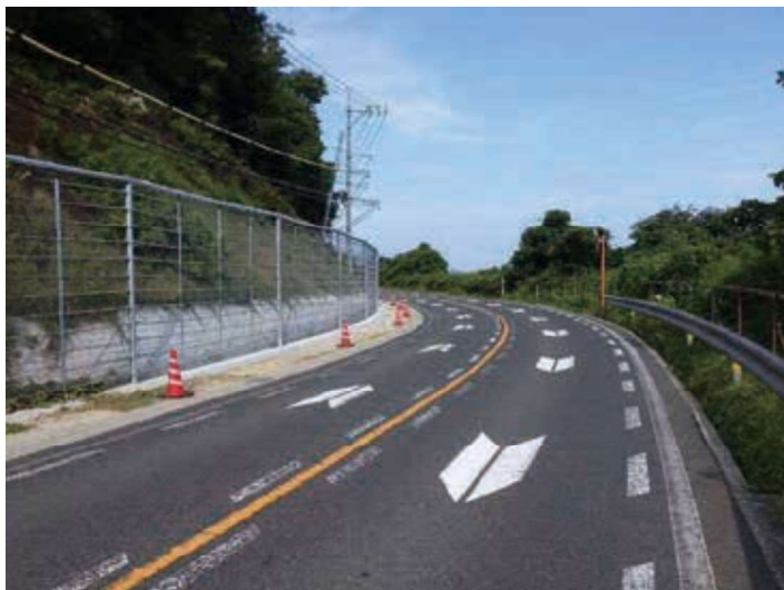
落石防護柵の整備例
