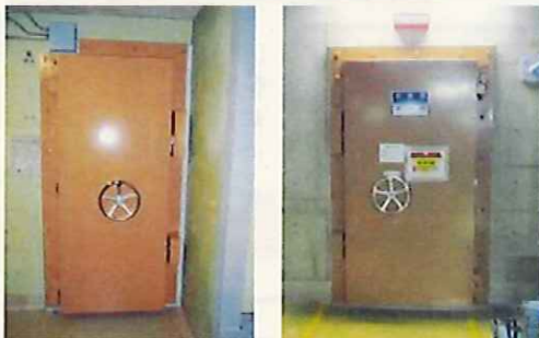
▲2号機建物内に設置した水密扉
