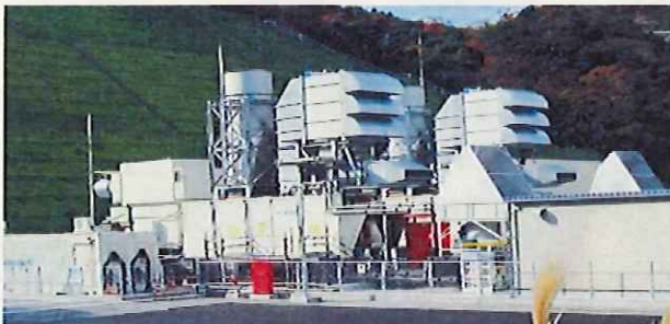
▲約40mの高台に設置したガスタービン発電機(12000kW級×2台)
