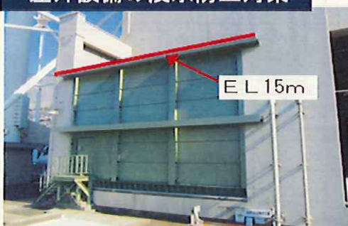
▲2号機変圧器エリアに設置した防水壁
