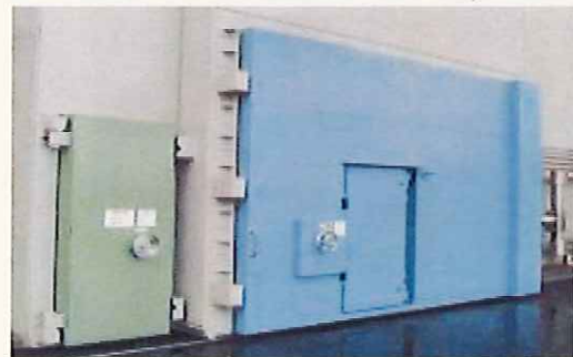
▲3号機建物外壁に設置した水密扉
