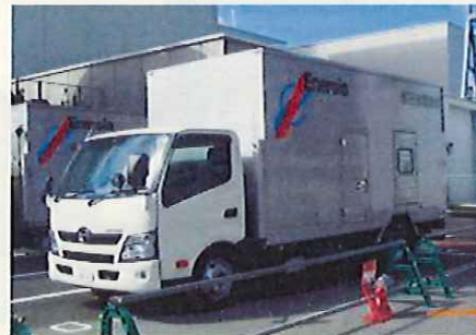
▲敷地内に配備した高圧発電機車。今後さらに追加配備する
