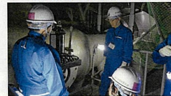
2号機トラス室内(真空破壊弁)
