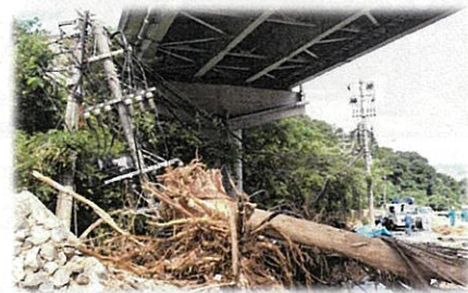
河川氾濫による電柱倒壊
