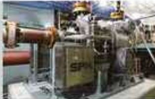
高圧原子炉代替注水ポンプ
