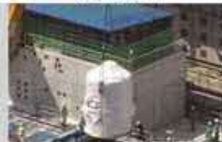
フィルタ付ベント設備
