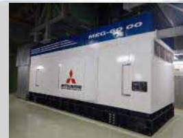
ガスタービン発電機
