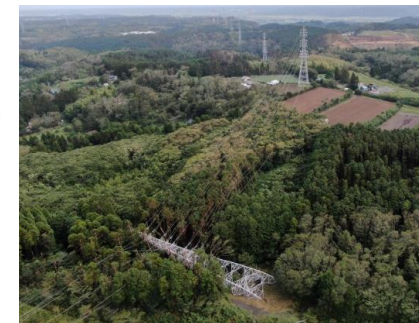
鉄塔設備の倒壊（君津市）
