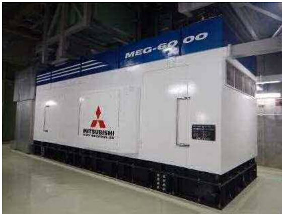
ガスタービン発電機 外観
