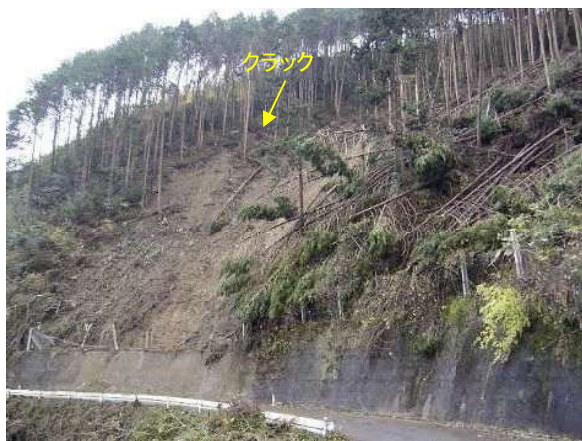
写真 2.8 崩壊斜面のクラック
