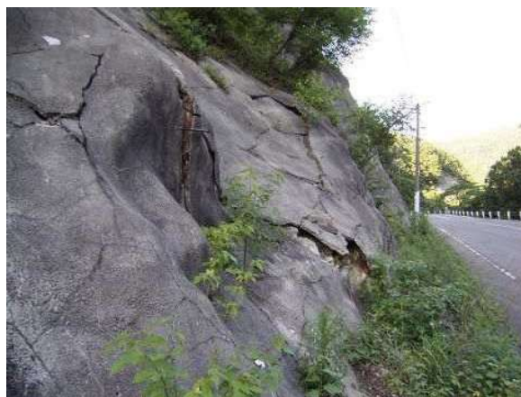
写真 2.5 浮き(全体的・寸法大の例)
