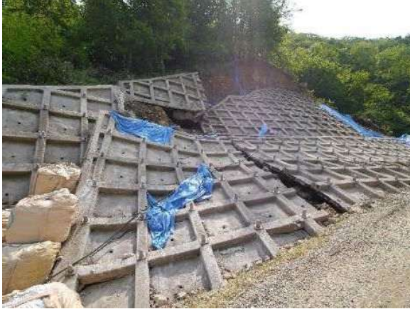
写真 2.11 法枠の崩壊の例
