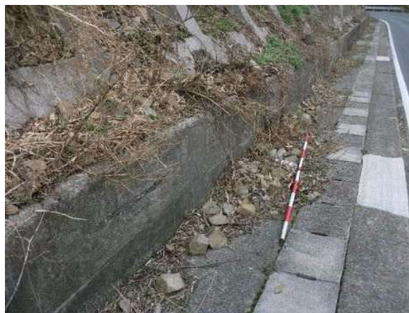
写真 2.15 法枠内にある浮石からの落石
