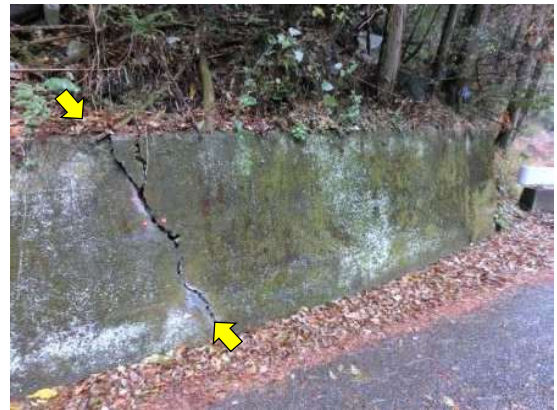
写真 2.21 段差のある開口ひび割れ
