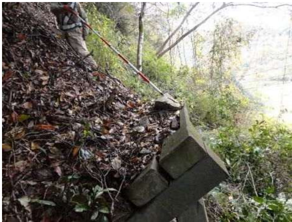
写真 2.31 防止柵背後の土石埋積
