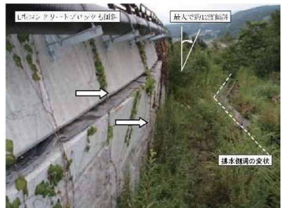
写真 2.22 ※1) テールアルメのはらみだし
