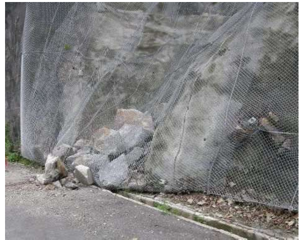
写真 2.20 ネット外への飛散
