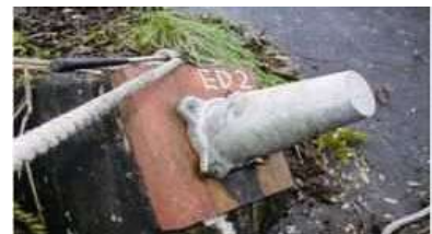
写真 2.34 防錆油の流出痕跡
