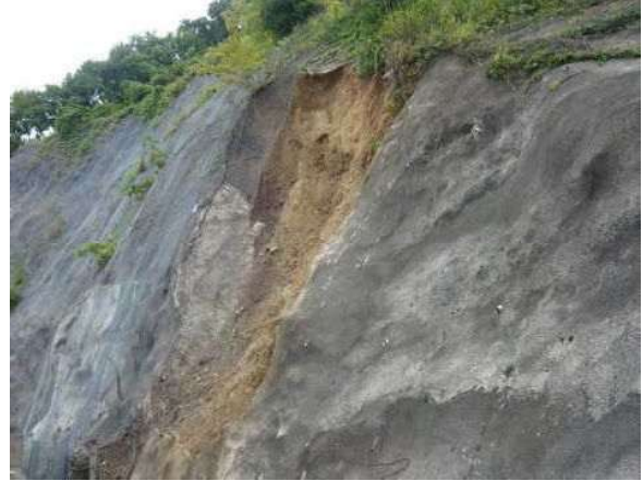
写真 2.1 モルタル吹付の崩壊例
