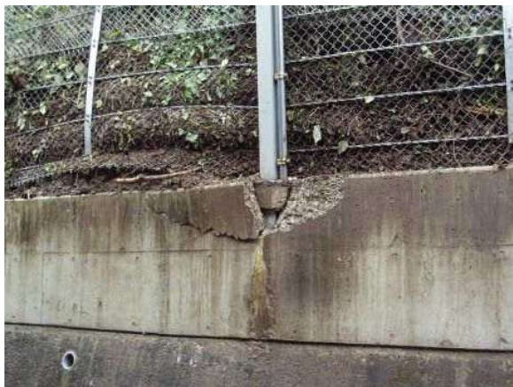
写真 2.28 支柱周りの擁壁割れ
