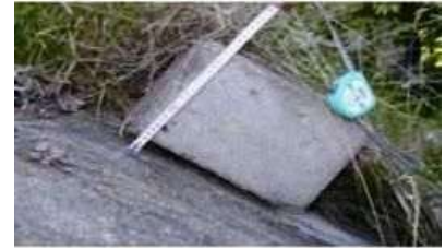
写真 2.32 頭部コンクリートの浮き上がり
