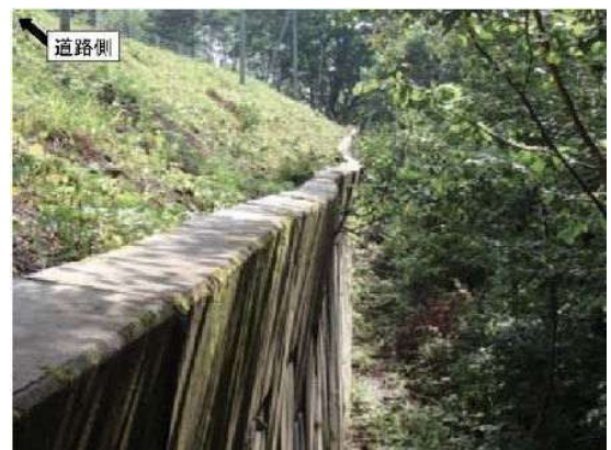
写真 2.23 ※1) テールアルメの傾倒
