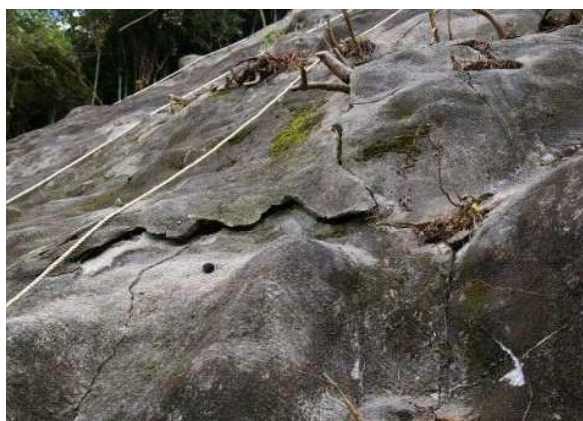
写真 2.2 地山との密着不良に伴う迫り出し
