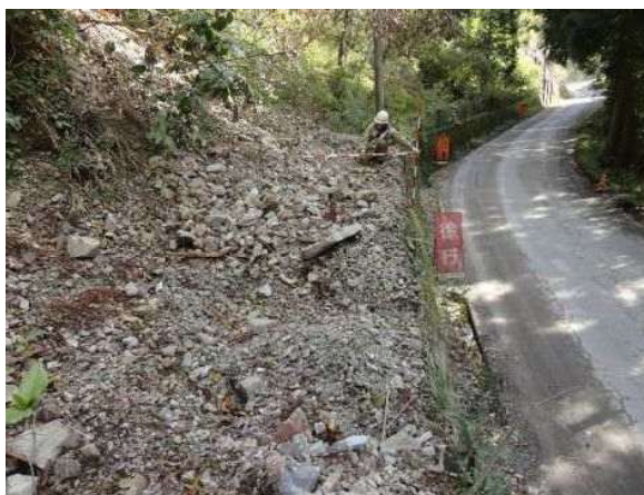
写真 2.30 背面ポケットの土石溢れ
