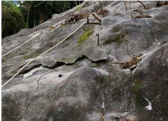
写真 2.2 地山との密着不良に伴う迫り出し
