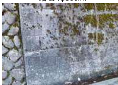
擁壁クラック箇所
