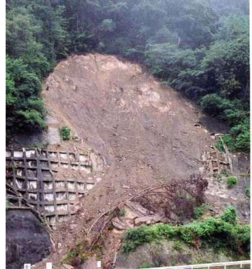
写真 2.12 法枠を巻き込んだ斜面崩壊
