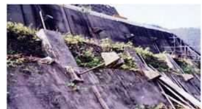
写真 2.35 頭部コンクリートの突出
