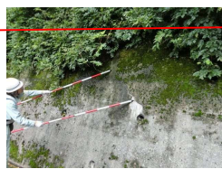
起点側、擁壁の遊離石灰
