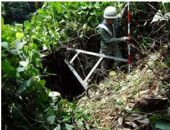
写真 2.16 植生に押し倒された支柱
