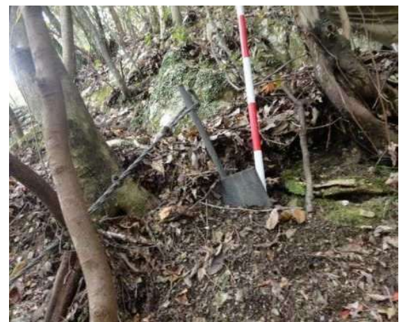
写真 2.18 アンカーの抜け出し
