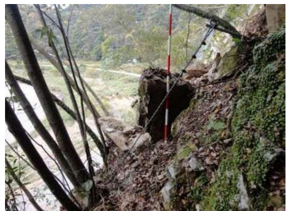
写真 2.10 法肩にある不安定な浮石
