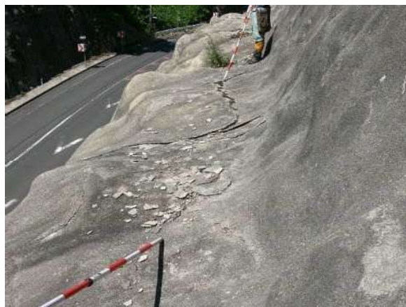
写真 2.6 小段における打音異常箇所の例
