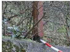
支柱の根元が腐食している
