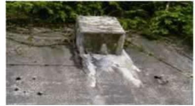
写真 2.33 遊離石灰の流出痕跡
