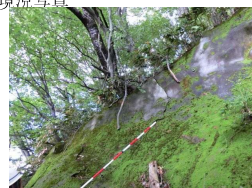
モルタルのクラック
