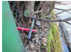
防護柵ワイヤーの抜け落ち
