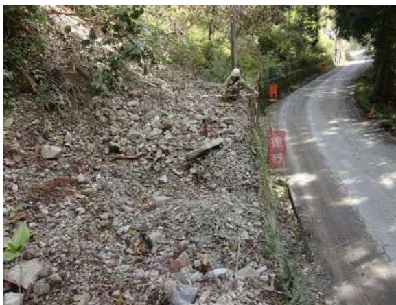
写真 2.30 背面ポケットの土石溢れ
