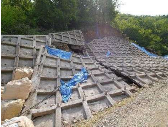
写真 2.11 法枠の崩壊の例
