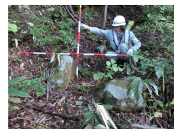
法面直上斜面の転石
