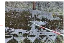
擁壁に逆離石灰が晶出
