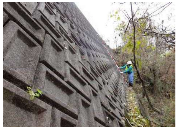
写真 2.26 水平方向に連続するはらみ出し
