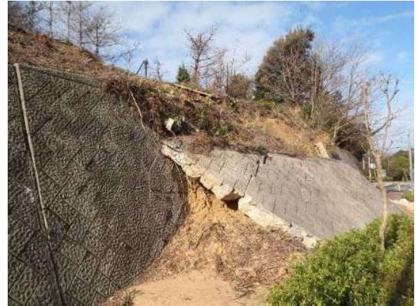
写真 2.24 ブロック積み擁壁の崩壊例
