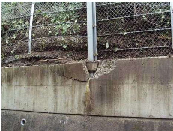
写真 2.28 支柱周りの擁壁割れ
