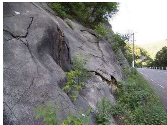
写真 2.5 浮き(全体的・寸法大の例)
