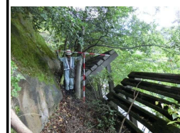
雪崩防止柵背面の状況
