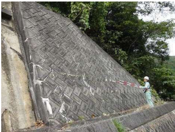
写真 2.25 水平方向に連続するひび割れ
