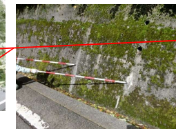
終点側、遊離石灰
