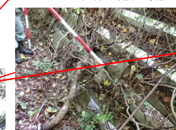
防止柵背面にモルタル片散在
