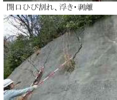
モルタルの開口ひび割れ
