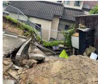
松徳学院高校寮の被災状況 災害復旧費用をクラウドファンディングで募集
