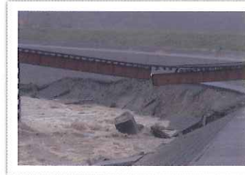
JR三江線被害(井原川鉄橋)
